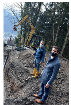
Christian Erhard und Simon Tschann beim Hochbehälter.
